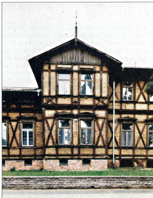
Abb. 23 Neue Neustadt, Lübecker Straße 130, Fachwerkkellerwand über 30 cm massivem Sockel unfachmännisch durch unverputztes Mauerwerk auf der linken Seite ersetzt
