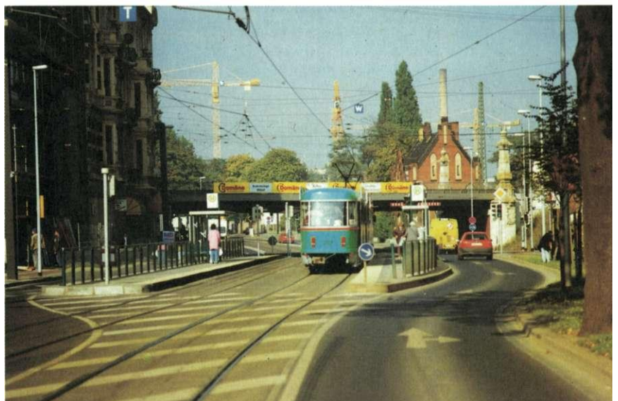
Neubau der Brücke der Bahn AG und Neubau der Kreuzung mit Haltestellenbereich, Lüneburger Straße/ Agnetenstraße
