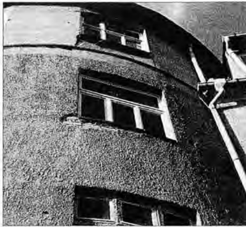
Bröckelnder Putz und alte Fenster sollen bald der Vergangenheit angehören: Das „Tintenfaß“ in der Wittenberger Straße wird saniert.
