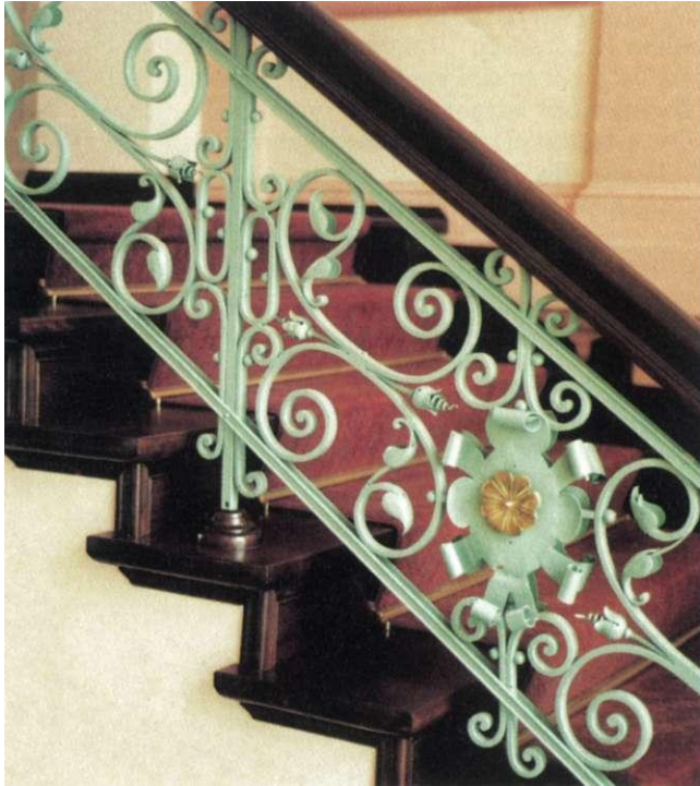
Abb. 84 Hegelstraße 34 Aus Vierkantstäben, Bandeisen und Eisenblech geschmiedetes Geländer zwischen Durchfahrt und Aufgang zum Erdgeschoß, 1888
