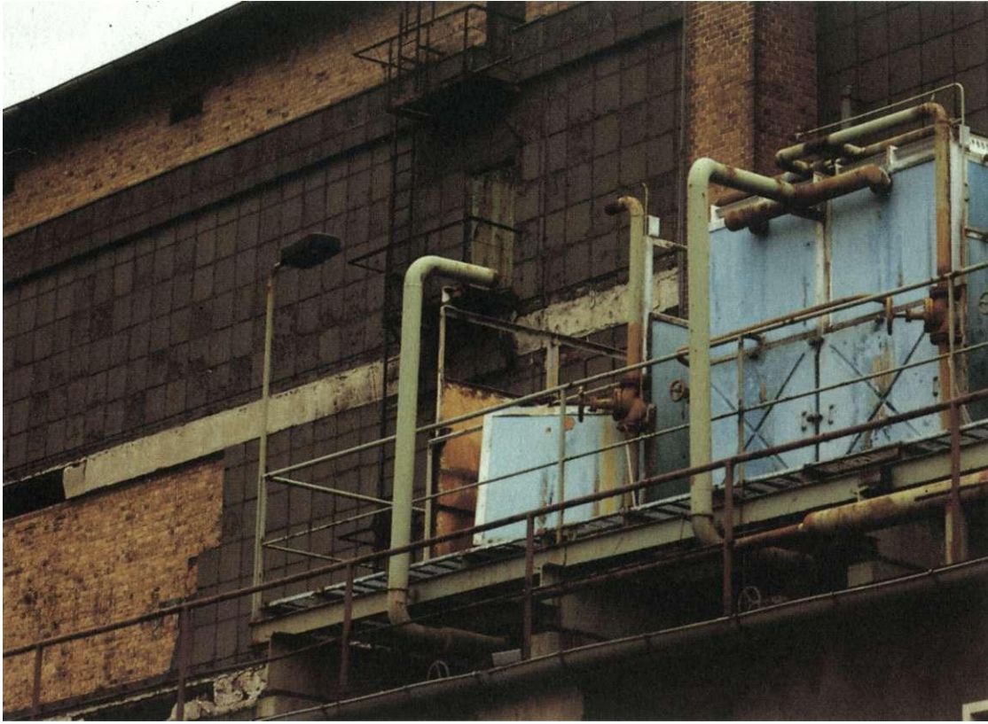
Kühlhaus mit an der Fassade nachträglich angebrachten Kühlaggregaten.
