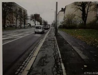
Lübecker Straße DTV ca. 17.000 Kfz/Tag Benutzungspflichtiger Radweg (1,20m Breite) zu schmal fehlender Sicherheitsbereich zur Fahrbahn Belagsqualität eingeschränkt
