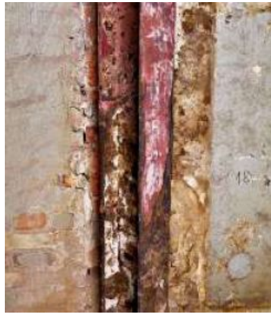
Diese Stahlträger in einem Keller des Archivs sind nicht mehr standsicher.
