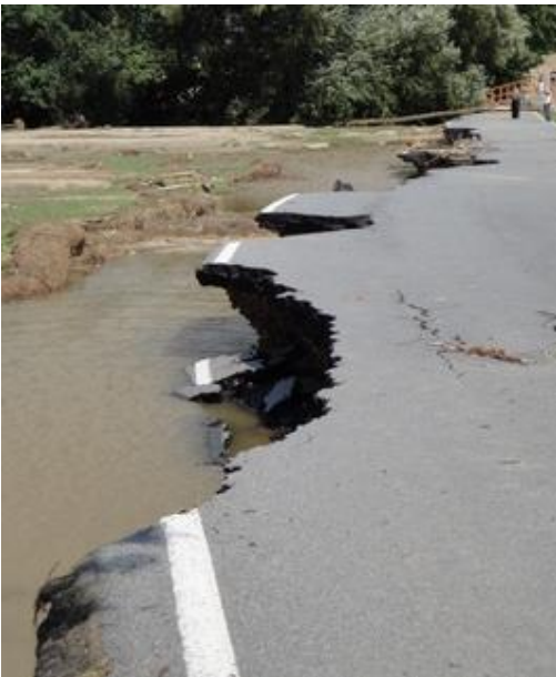
Abbildung 27: Unterspülte Straße (© Julian Nitzsche / PIXELIO)
