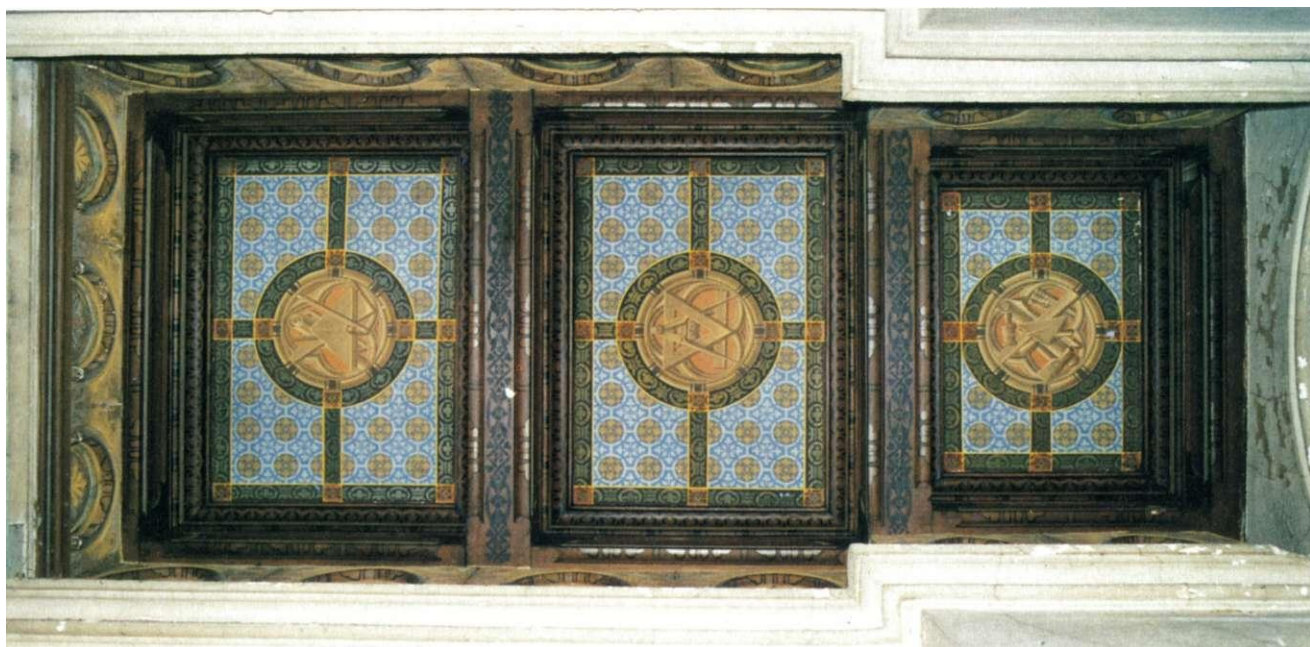
Abb. 128 Sternstraße 29 b ▼ Vorgefundener Zustand des Deckenbereiches mit den drei Kassettenfeldern. Die sichtbare Fassung ist im Laufe der Jahre mehrfach überarbeitet worden. Im Randbereich zeichnen sich Schäden und Verluste in der Substanz ab.
