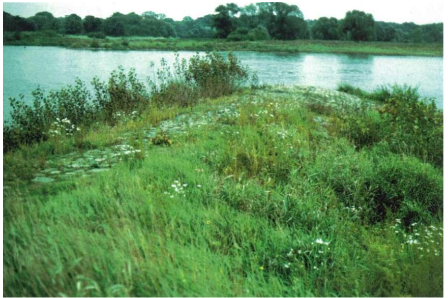
Foto 27: Bühne als Uferbefestigung in der Elbe
