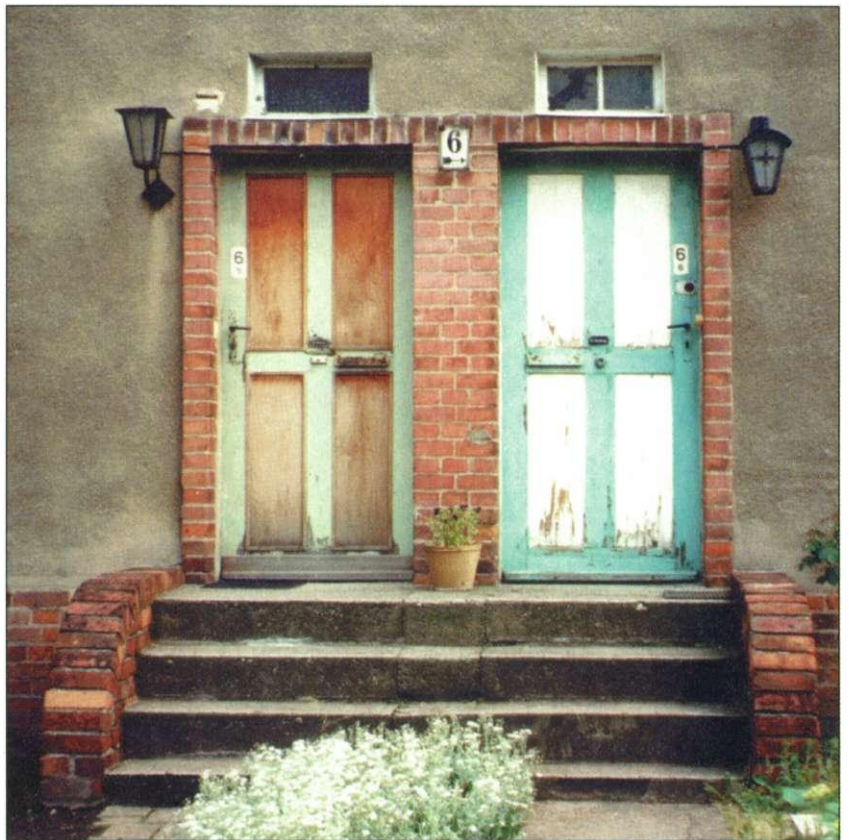
Zustand der Türen vor der Restaurierung.
