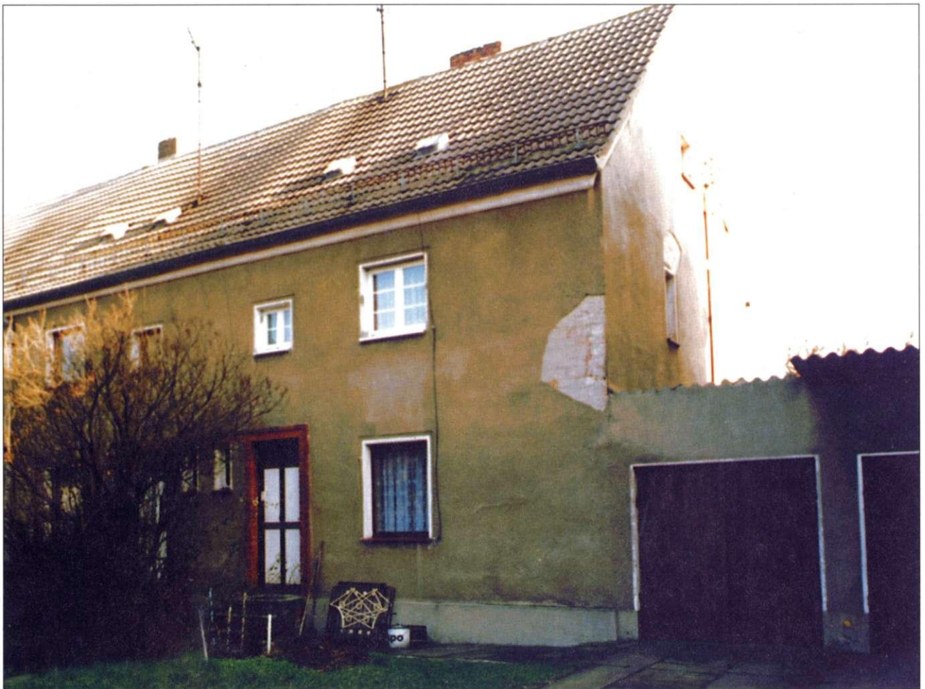
An vielen Häusern zeigen sich offensichtliche Baumängel, wie hier fehlende Putzpartien.
