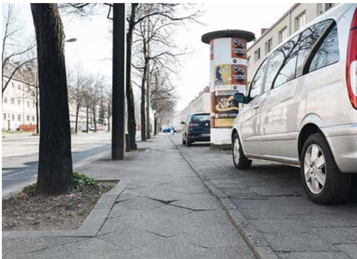
Abbildung 20: Sanierungsbedürftiger Radweg und unerlaubtes Gehwegparken in der Großen Diesdorfer Straße in Stadtfeld West
