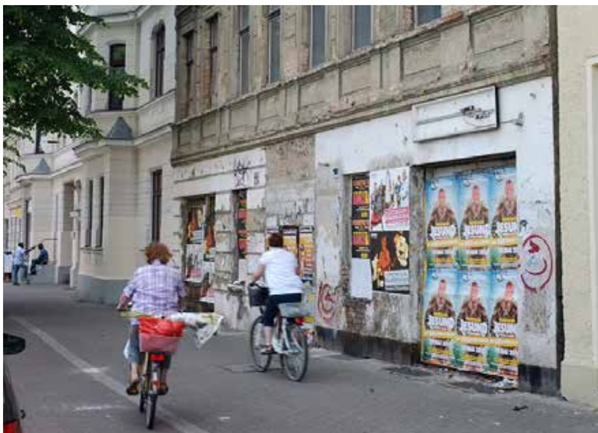
Abbildung 65: Leerstand wegen fehlender Sanierung in der Olvenstedter Straße in Stadtfeld Ost
