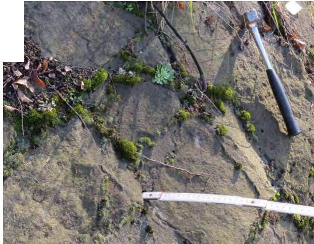
Offene Fugen, hier 20 cm tief
